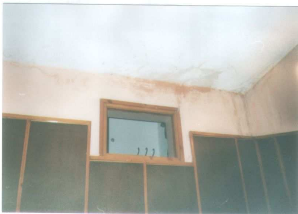
Rys.2 Zacieki na suficie i ścianach widoczne od wewnątrz sali widowiskowej
