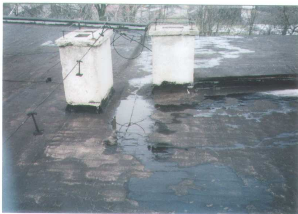
Rys.3 Zagłębienia w koszu dachu nad widownią, bez poprawnego odpływu wody
